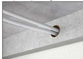
Tubos passando por uma viga
