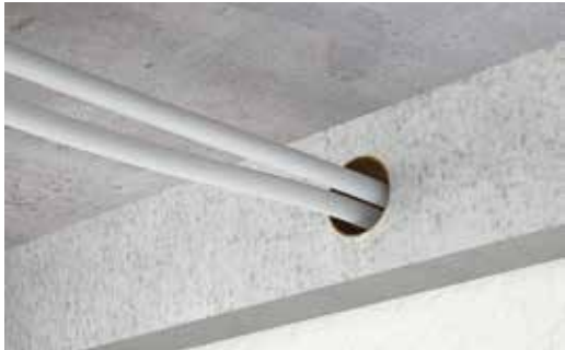
Tubos passando por uma viga
